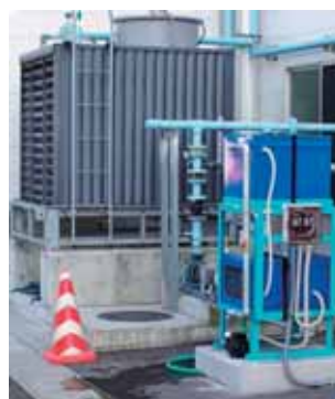
クーリングタワー循環水水質改善装置
