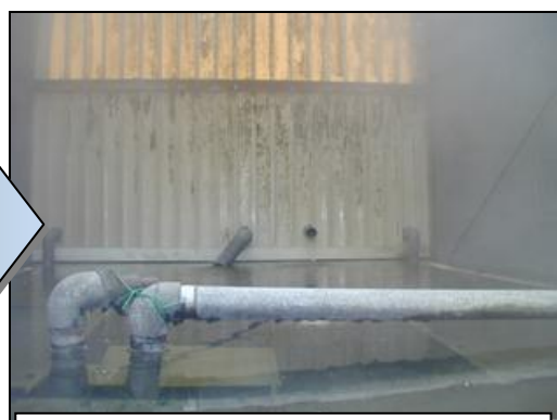
冷却塔循環水処理装置 設置後
